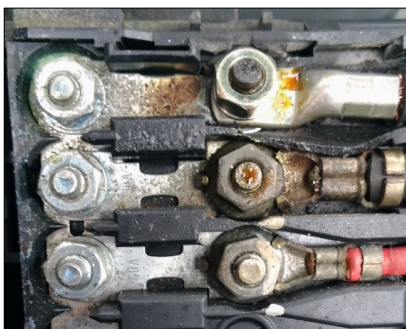
Abb. 67: Beispiel einer fehlerhaften Anschlussklemme, ersichtlich durch Verfärbungen.
