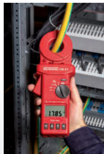
Messung des Betriebsresder einer Industrieverteilung
