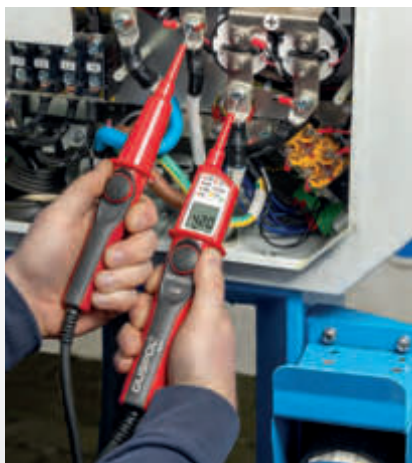
Prüfung der Ausgangsspannung einer DC-Ladeeinrichtung
