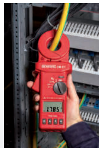
Messung des Betriebserders einer Industrieverteilung
