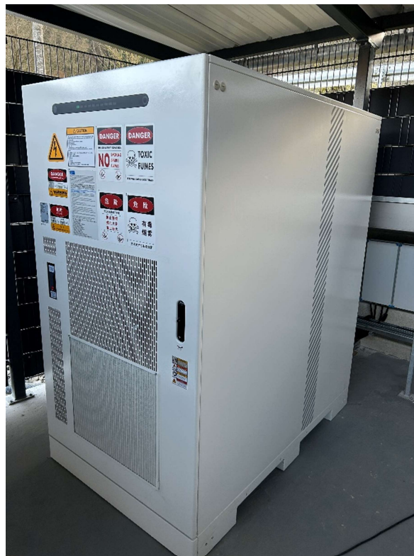
Bild 3: Energiespeicher Typ LUNA2000-215-2S10
