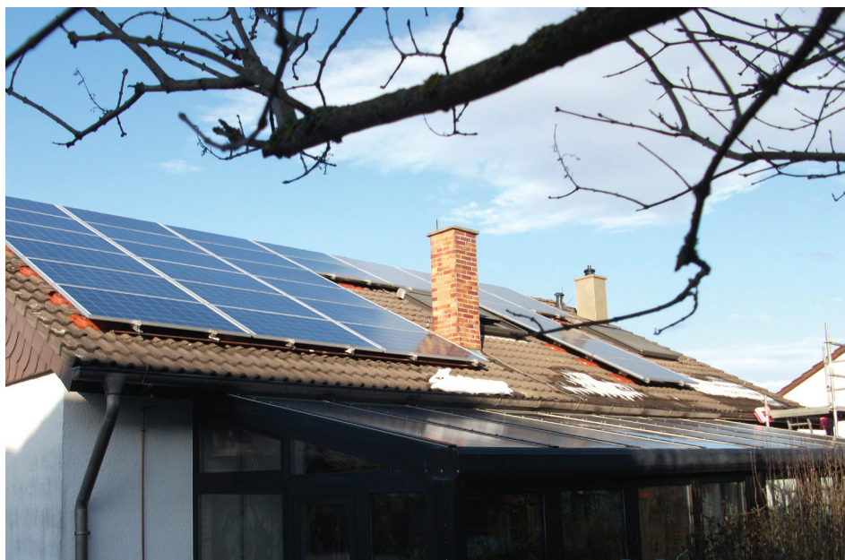
Das Foto zeigt, wie Leistungsoptimierer die Möglichkeit bieten, Module nah an dem Schornstein zu installieren, ohne unverhältnismäßige Energieeinbußen zu riskieren.
