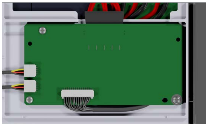
Fig. 4.11: Vista degli scaricatori di sovratensione CC con coperchio rimosso
