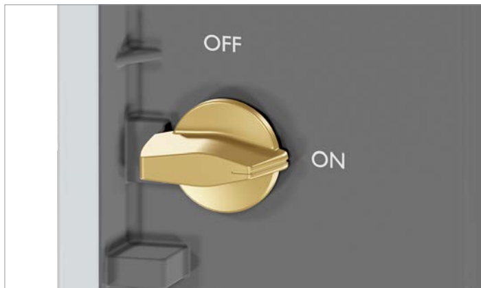
Fig. 4.9: Il sezionatore CC in posizione ON (ACCESO) = il collegamento ai pannelli solari è chiuso
